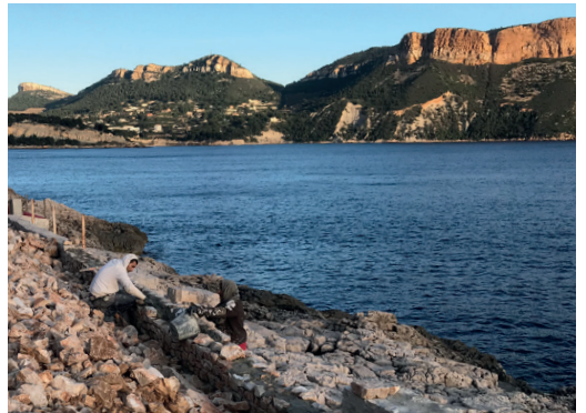
TERRASSEMENT DE LA PISCINE Construction du muret de limite séparative Construction du parement de la piscine
